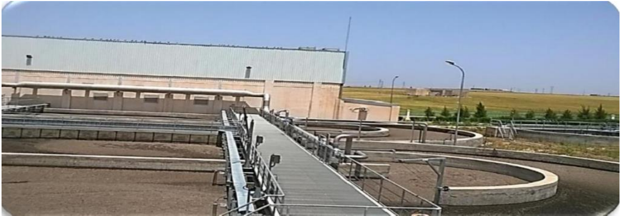
Figure 25 : Le digesteur des boues épaisses(Hafsaoui,2020)
