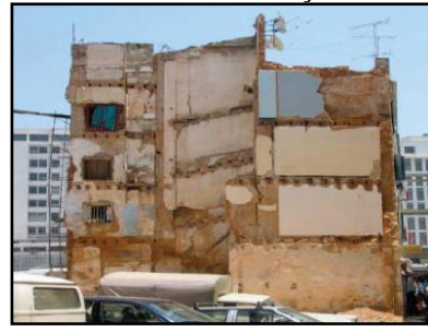
Fig 22 : bâtisse dans la base casbah menaçant ruine
