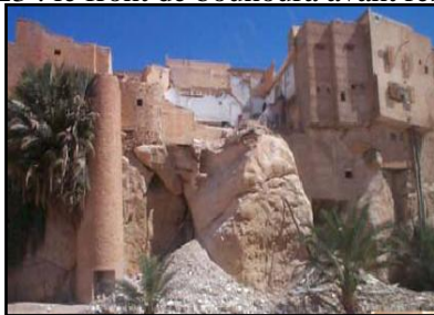
Fig 23 : le front de bounoura avant restauration
