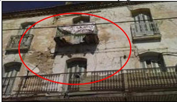
Fig 50 : La surexploitation des immeubles accompagnée d'un manque d'entretien;
