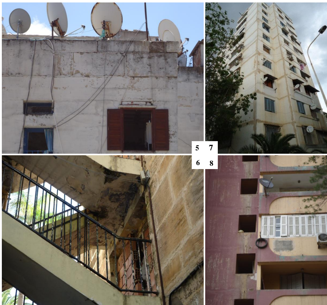
Photos : 05. Apparition des fissures après le séisme de Boumerdes - Climat de France 06. Dégradation des cages d'escalier - Diar El Mahçoul 07. Problème des joints - Soummam 08. Façade tachetée - RABIA (Source : auteur, 2013)
