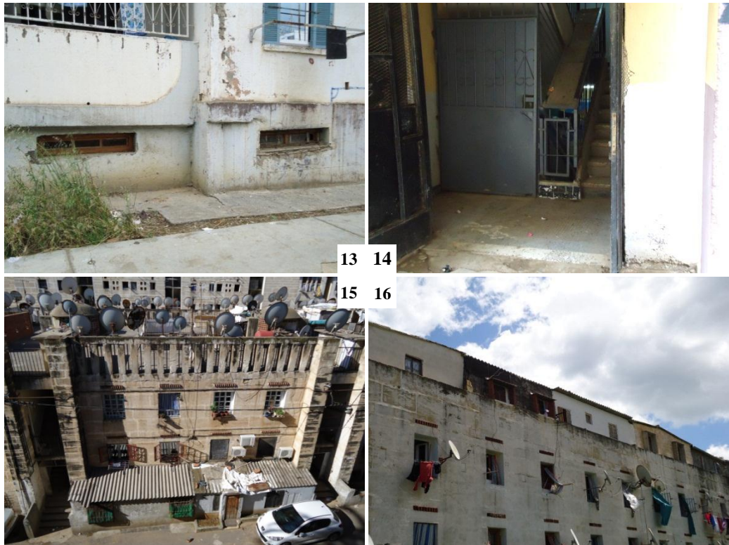
Photos : 13. Vide sanitaire transformé en logement – Soummam . 14. Cage d’escalier habitée par une famille – RABIA . 15. Squat de la voie piétonne par une extension - Diar El Mahçoul . 16. Terrasse accessible transformée en habitat informel - Climat de France . (Source : auteur, 2013)
