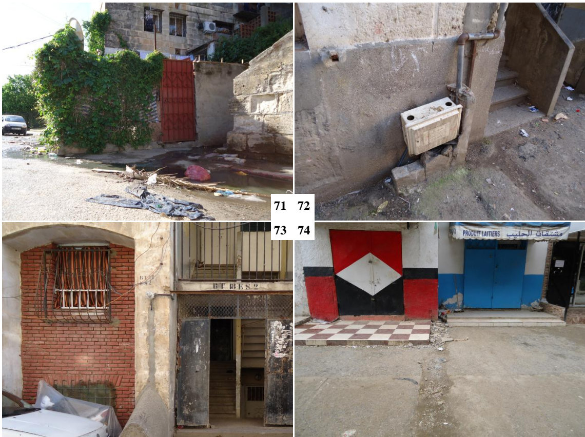
Photos : 71. Le refoulement d'un regard de jonction - Diar El Mahçoul - 72. Réseau d'A.E.P très vétuste en tuyauterie galvanisée - Climat de France - 73. Branchement du gaz sans aucune prise en compte des normes - Diar El Mahçoul - 74. Les branchements illicites d'eau potable - Soummam ( Source : auteur, 2013 )
