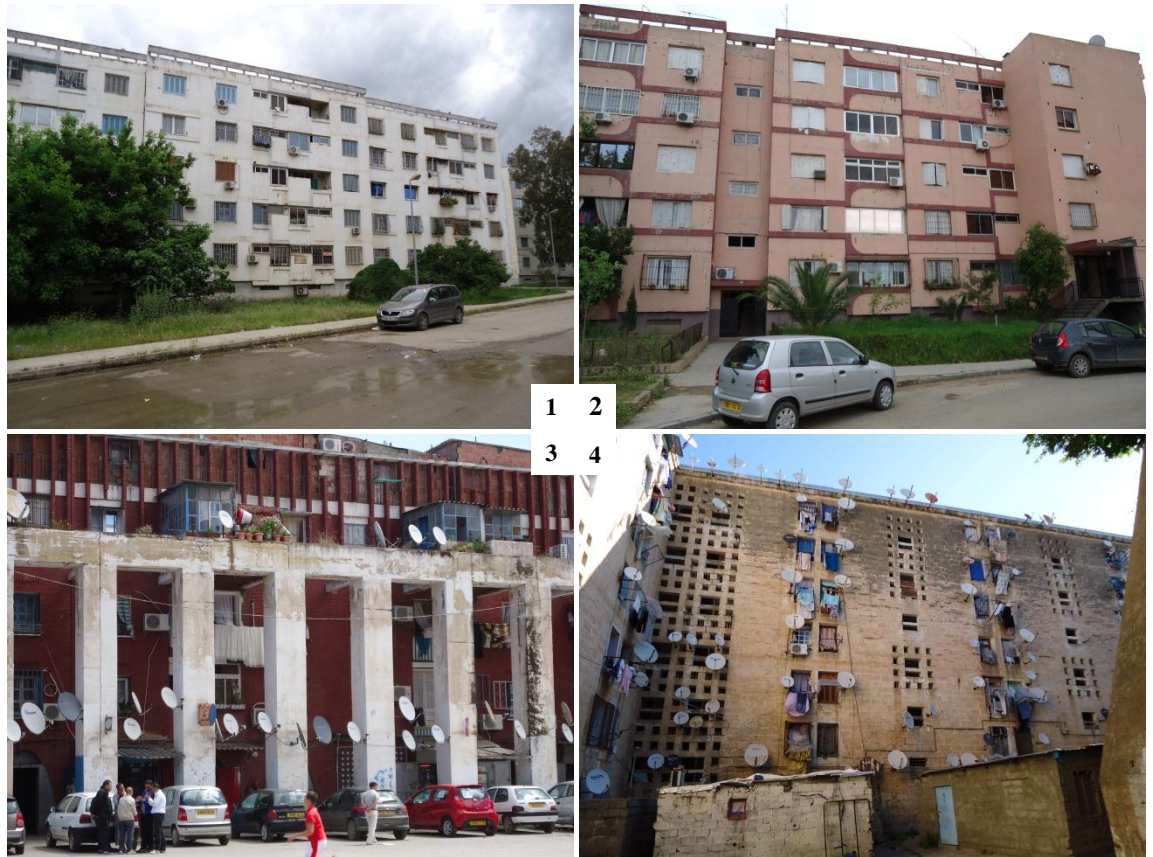
Photos : 1. Cadre bâti en moyen état (Soummam). 2. Cadre bâti en moyen état (RABIA). 3. Cadre bâti menaçant ruine (Climat de France). 4. Cadre bâti en mauvais état (Diar El mahçoul) (Source : auteur, 2013)
