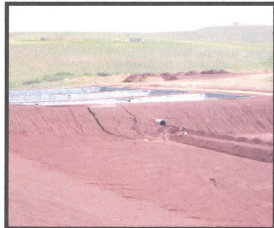
Photo N° 05 :BASSIN POUR LIXIVIAT
