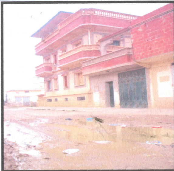
Photo N° 01 :Etat de la voirie dans un lotissement secteur 05
