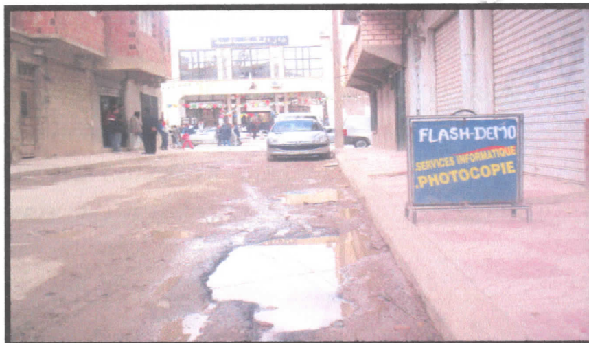
Photo N° 02 :dégradation de la voirie dans le centre urbain
