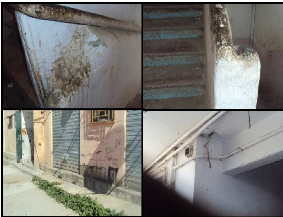
Photos n°63, 64, 65, 66 : centre ville de khenchela, la dégradation des parties communes (la cage d'escalier, l'entrée de l'immeuble) au niveau des immeubles collectifs ( HLM) Source : auteur 2011
