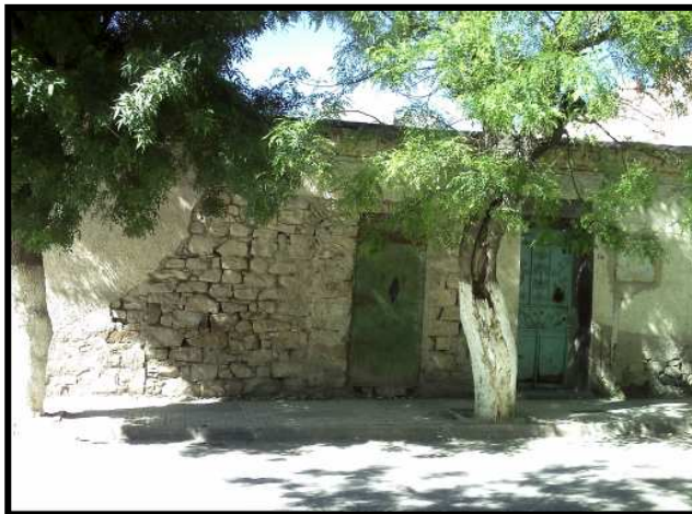
Construction en mauvais état
