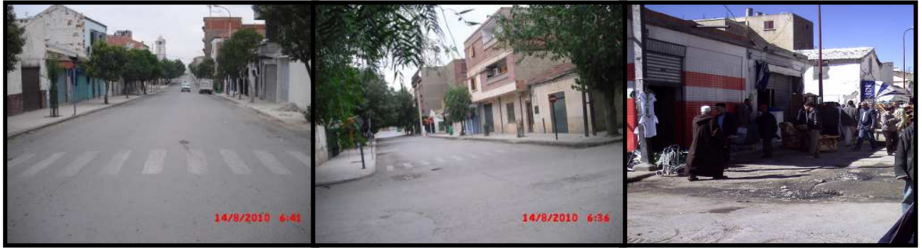
Photos n° 36, 37, 38 : centre ville de kenchela, Variance de l'état physique du réseau routier (bon état, moyen état et mauvais état). Source : auteur (2010).
