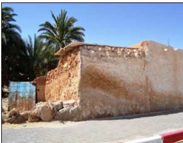
Photo5.39 : Fissures, traces humides bâties du type traditionnel (Bayadha Est cité L’ebbama)
