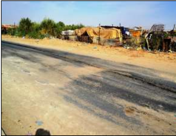
Photo 5.4 : Effondrement sec d'un axe structurant (quartier Chott)
