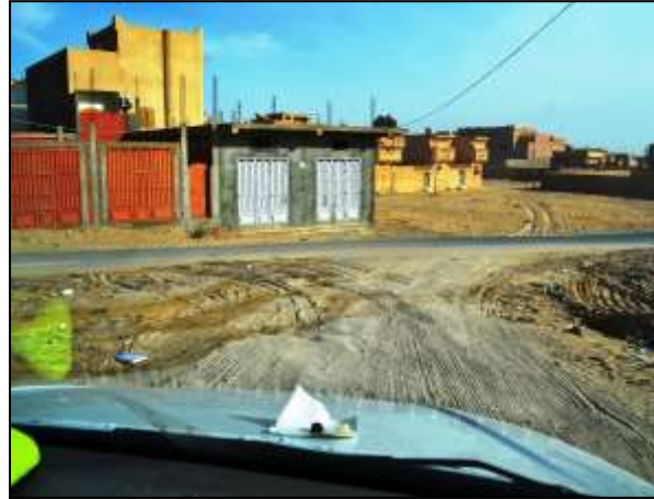
Photo 5.7 : Effondrement humide d'un axe structurant (quartier Msaaba)
