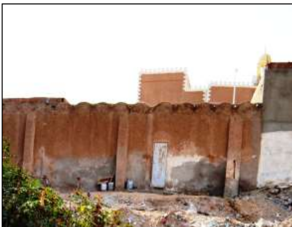
Photo 5.24 corrosion murs et pilier bâti du type traditionnel (quartier Msaaba)
