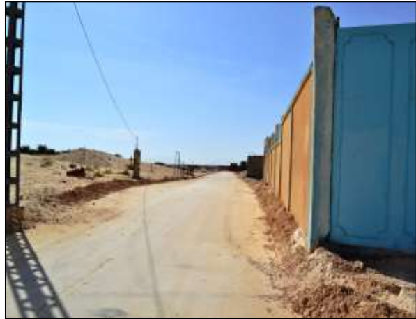
Photo 5.5 : Fissure après chaque réparation d'un axe structurant (Sahen02)
