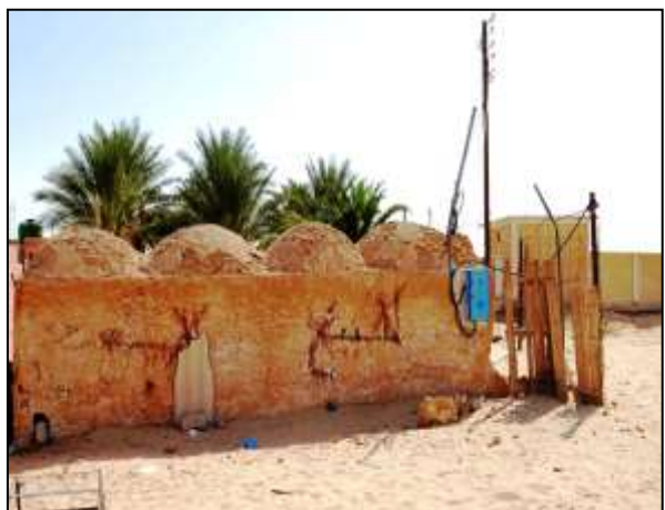
Photo 5.25 corrosion murs et fissures bâti du type traditionnel (quartier Sahen02)
