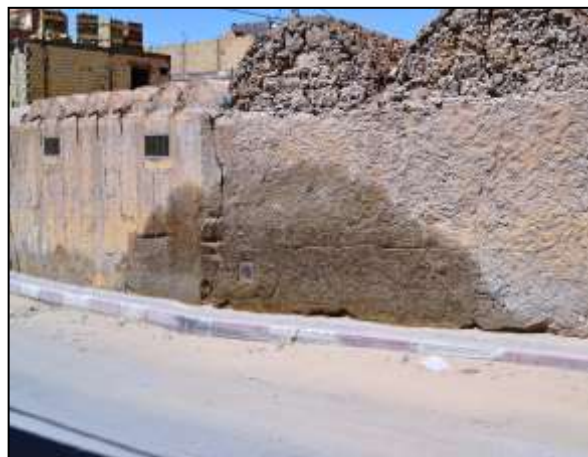
Photo 5.50 : patrimoine architectural subis des désordres physicochimiques
