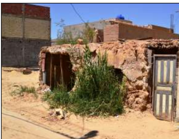
Photo 5.20 : Corrosion, dégradation des murs et piliers (quartier Sidi Mastour)
