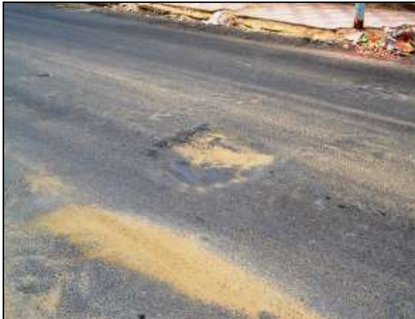
Photo 5.9 : Fissures, effondrement sec (quartier Nezla)
