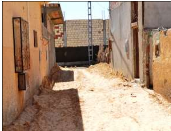
Photo 5.13 : Traces humides axe tertiaire (quartier Sidi Mastour)
