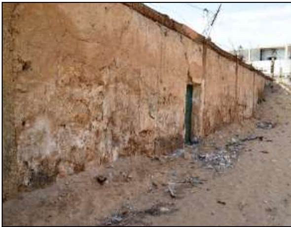
Photo 5.22 : Corrosion des murs et piliers (bâti du type traditionnel quartier Chott)
