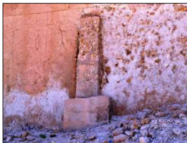
Photo 5.21 : Fissures, corrosion murs et pilier (quartier Sidi Mastour)
