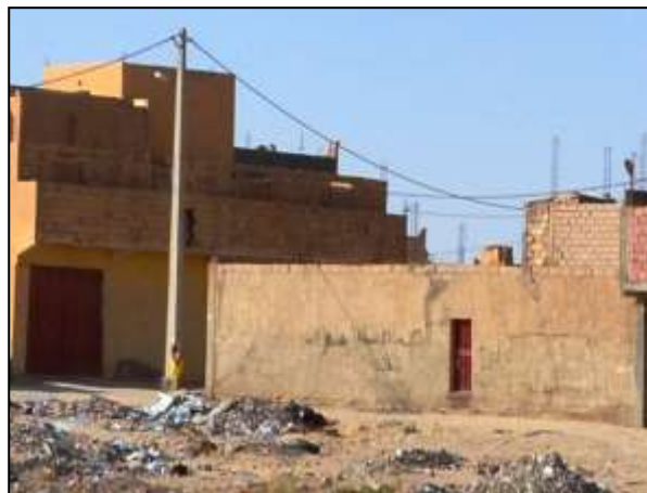
Photo 5.44 : fissuration permanente bâtie du type traditionnel (Robbah/Chaabna Est)
