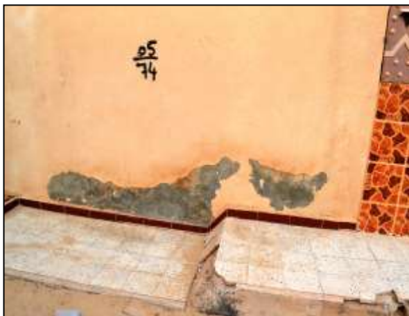
Photo 5.28 corrosion murs (bâti nouveau quartier Chott)
