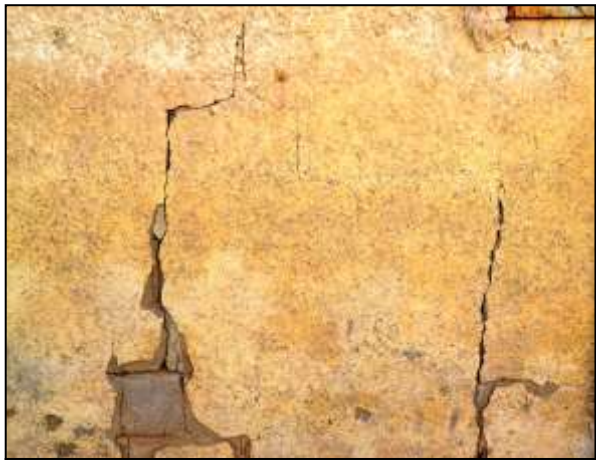
Photo5.27 : corrosion et fissures (quartier Nezla)
