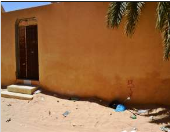
Photo 5.48 : bâti du type traditionnel corrosion chimique annuel
