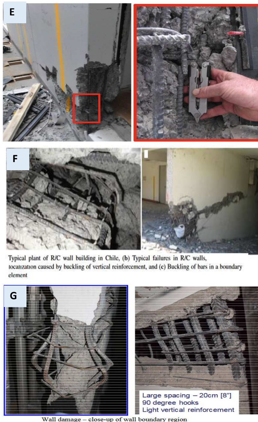
Figure 2.10 : Flambement et rupture des barres d'acier [34]
