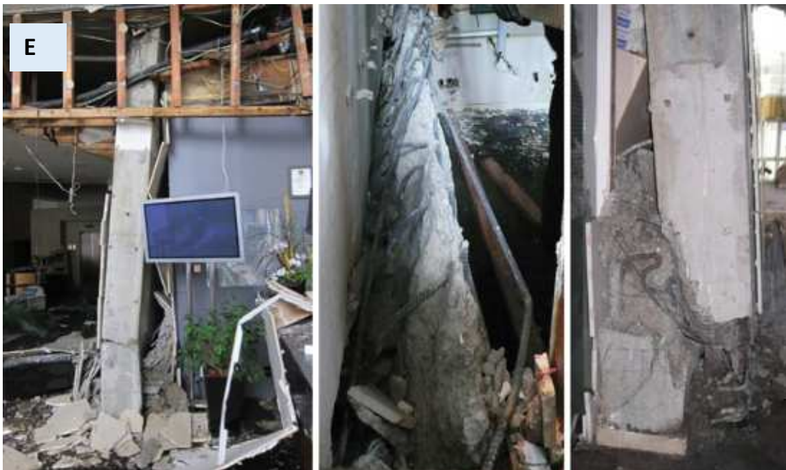
Figure 2.9 [34, 21]: a)- Flambement du talon d'un voile structural en profilé b)- Rupture des Armature longitudinales
