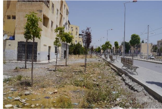
Photo 25: Ecart de conception : l'absence des aménagements des abords de tramway de Sétif Source Auteur, 2019
