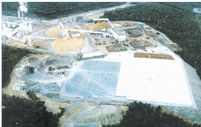
Figure 2.2 : Vue aérienne lors de la construction du revêtement à l'usine de papiers Domtar [28]
