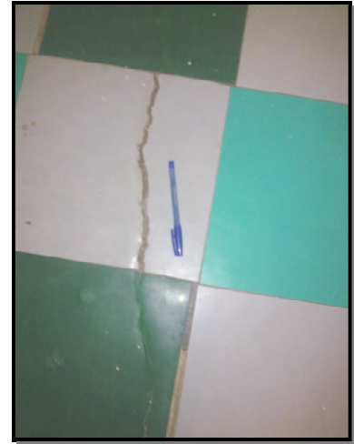
الصورة 2: تشققات داخل المساكن
