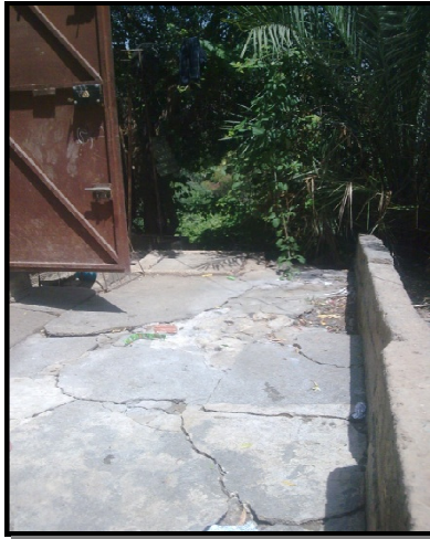
الصورة 3: تشققات للمساحات الخارجية
