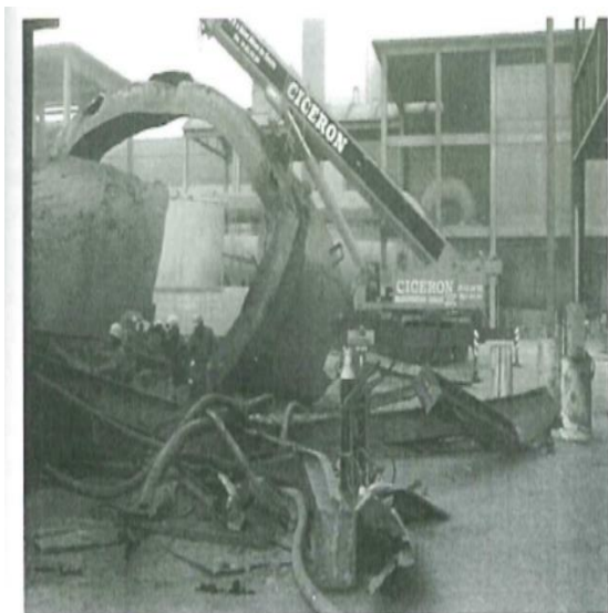
Figure 01 : Flambement de colonne métallique En cas réelle. Réf [2].
