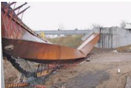
Figure 03 : Déversement de poutre métallique. Réf [4].
