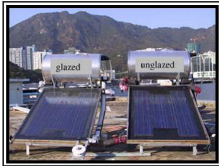
Figure 3.19 : Premier et second prototypes construits [131].
