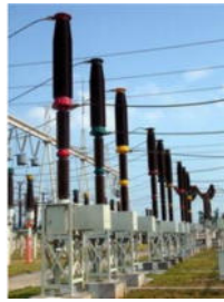
Disjoncteurs SF 6 monophasé
