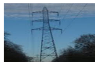
Pylône Double drapeaux
