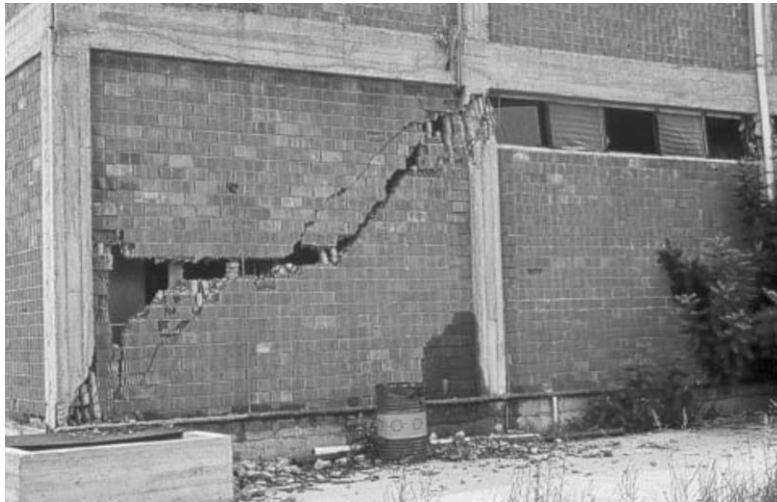
Figure I.1: l'endommagement diagonale du mur hors d'un séisme
