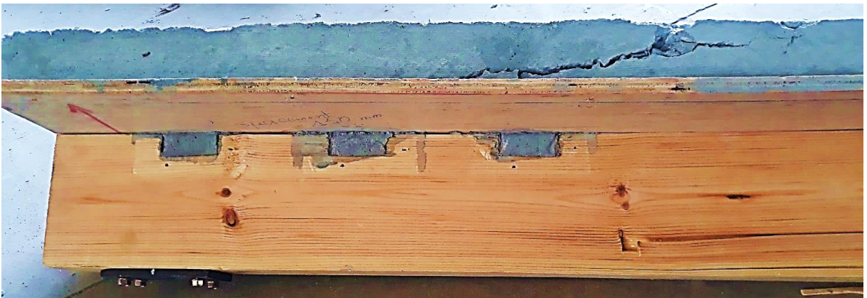
Figure 5.18: Fracture inclinée latérale dans la dalle et des micros fissures apparus à la deuxième connexion.
