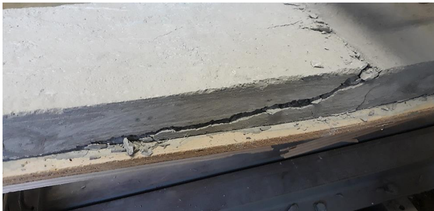
Figure 5.15: Fracture inclinée de la dalle en béton de la poutre B+INC.
