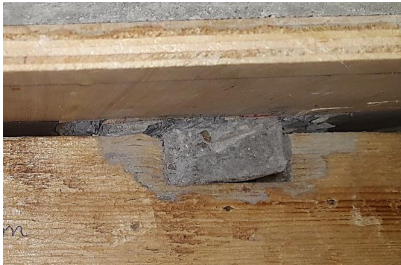
Figure 4.28: Écrasement par compression de bois en contact avec l'entaille renforcée par un INC.
