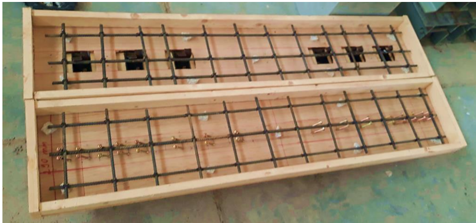
Figure 5.6: Les poutres mixtes avec la section B avant le coulage de béton.
