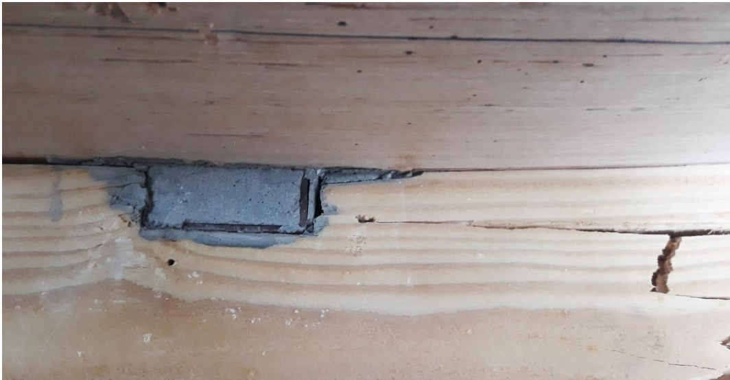
Figure 5.20: Ouverture avant la connexion INC due à la fracture de la poutre en bois.
