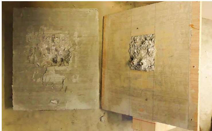
Figure 4.25: Arrachement des vis et séparation du bois de la dalle en béton.
