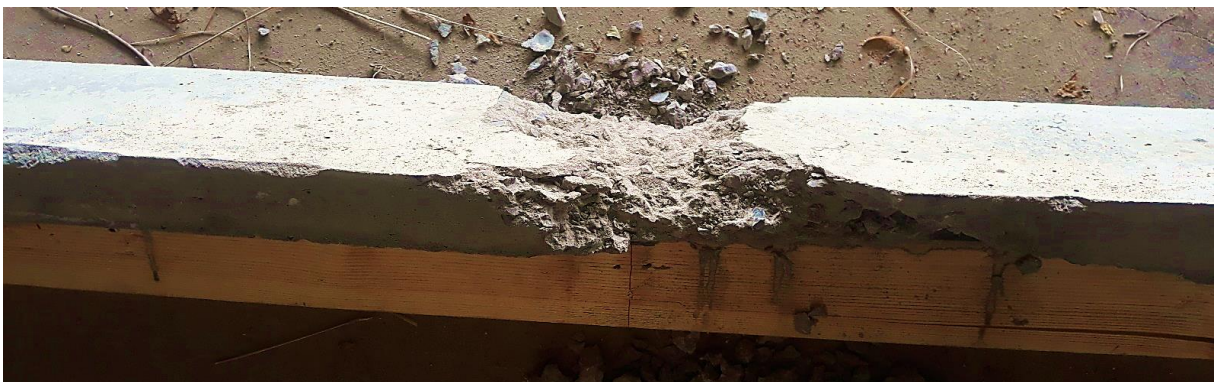
Figure 5.25: Détérioration de béton de la dalle à mi-travée de la poutre B+s après détachement.
