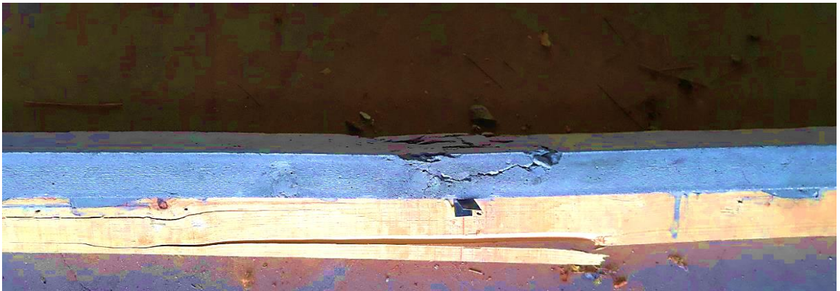
Figure 5.26: Première rupture de la poutre B+TRZ : traction par flexion des fibres inférieures et éclatement du béton.
