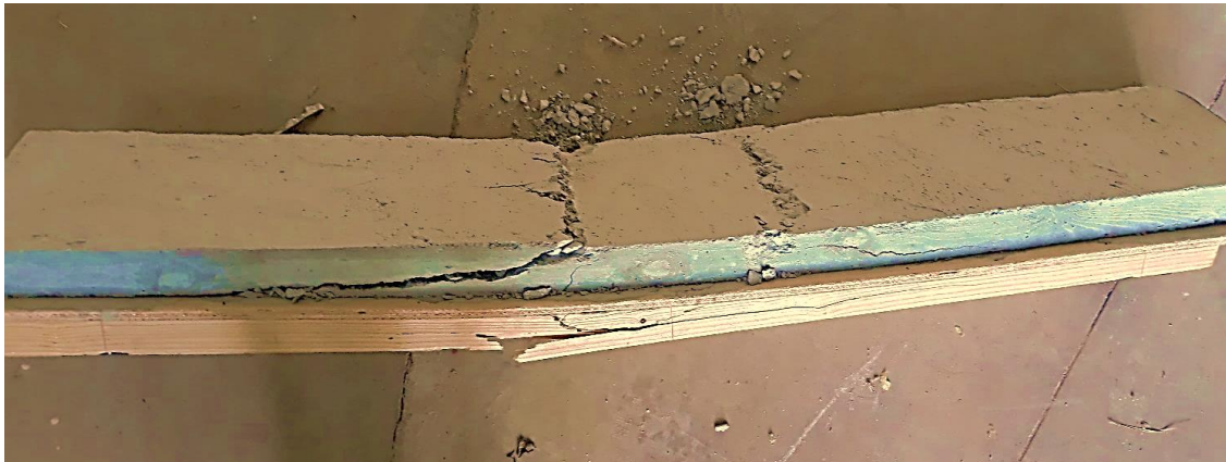
Figure 5.14: Les premiers signes de rupture : traces des rotules de vérin aux points d'application des forces sur la dalle en béton.
