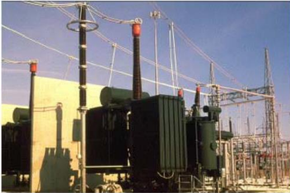
Figure 4-7 : image d'un poste de transformation HT avec parafoudre
