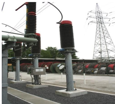
Figure 5.9 transformateur de potentiel
