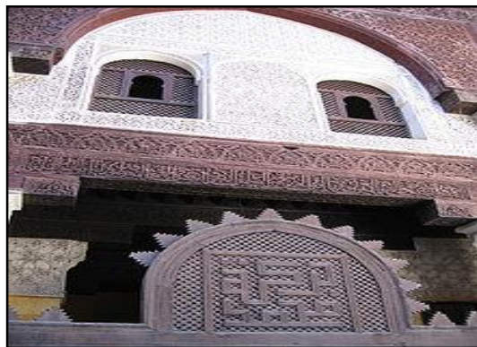
Photo n°19 : Risque d'effondrement des murs
