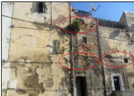
Photo n°149 : Une façade dégradée d'une maison traditionnelle au centre historique de Béjaïa
