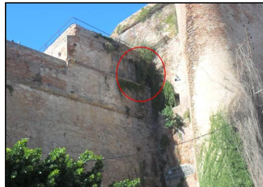
Photo n°126 : Enracinement des plantes sur les murs de la Casbah
