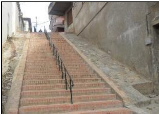
Photo n°69 : Un escalier avec un revêtement inadéquat au centre historique de Béjaïa
