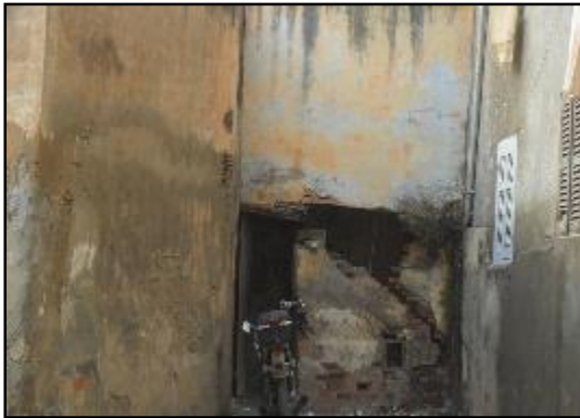
Photo n°67 : Une impasse en mauvais état au centre historique de Béjaïa
