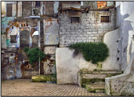
Photo n°35 : Un immeuble menace de ruiner, Casbah d'Alger
