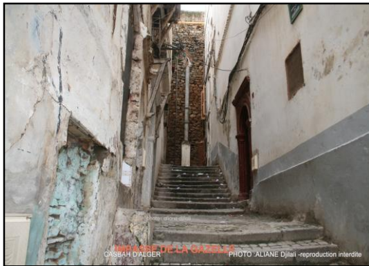
Photo n°37 : Impasse dégradée, Casbah d'Alger
