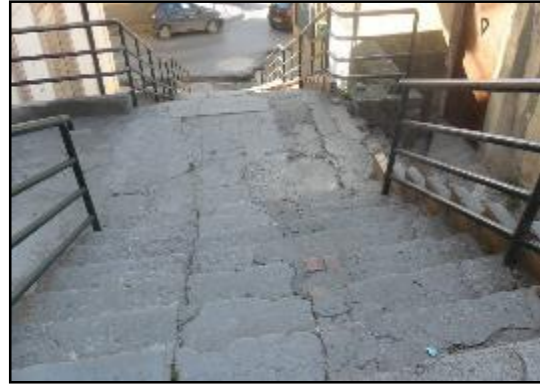
Photo n°68 : Un escalier en mauvais état au centre historique de Béjaïa
