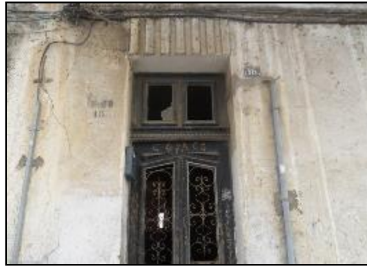
Photo n°157 : L'état dégradé d'une maison coloniale individuelle au centre historique de Béjaïa
