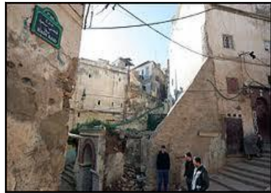
Photo n°36 : Détérioration des façades, Casbah d'Alger
