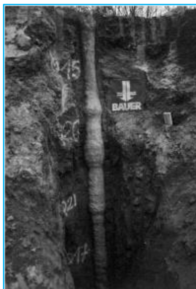
Figure 1.11. La colonne de CSV de type B. [16] [17]
