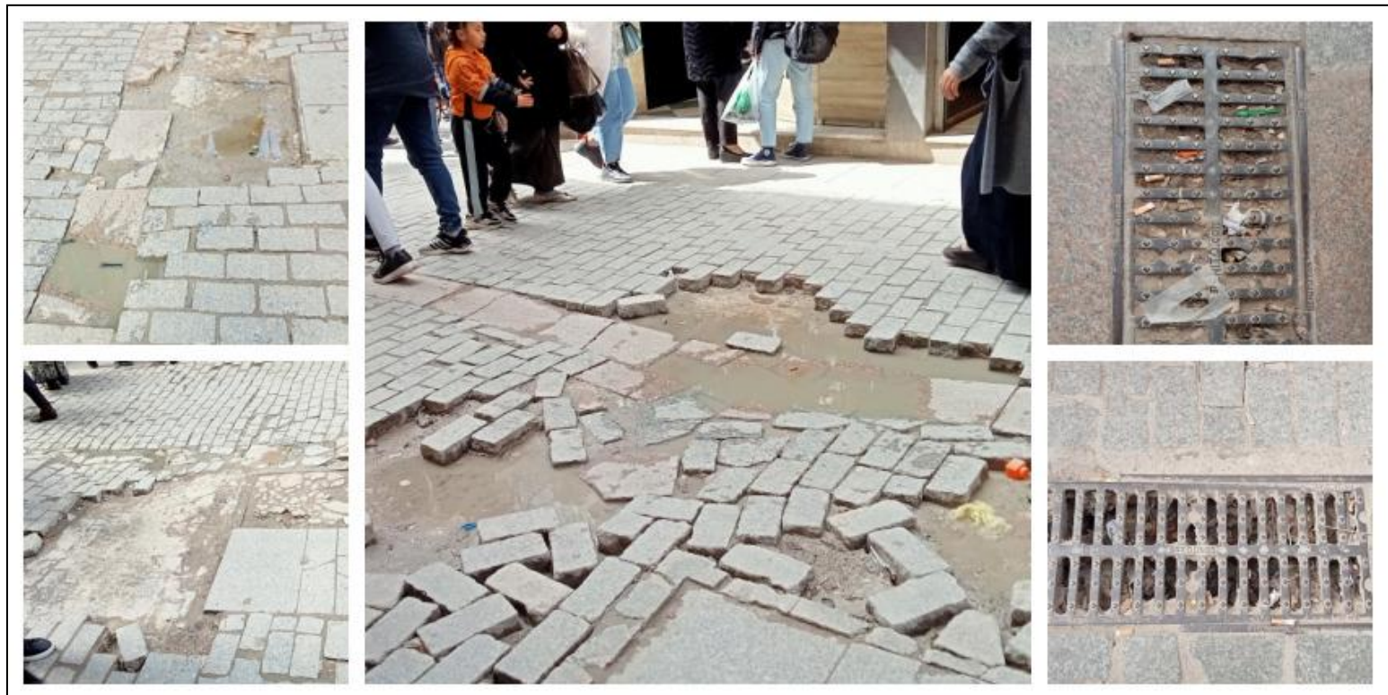
Figure 95: revêtement détérioré, évacuation bouchée et eaux stagnés
