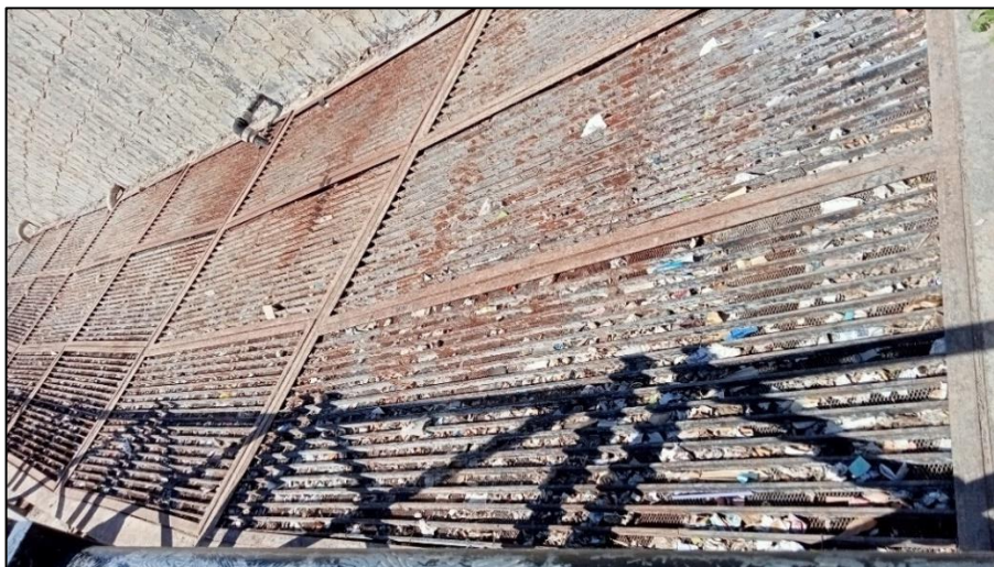
Figure 45: les évacuations des eaux sont bouchées par les ordures
