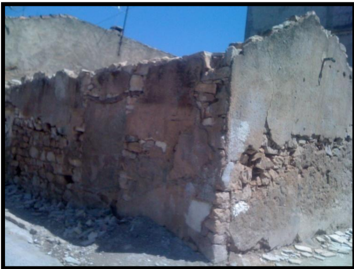
الصورة رقم 40 : انهيار السكنات الفردية ذات النمط الاستعماري في مركز المدينة المصدر : تحقيق ميداني 2013/05/06
