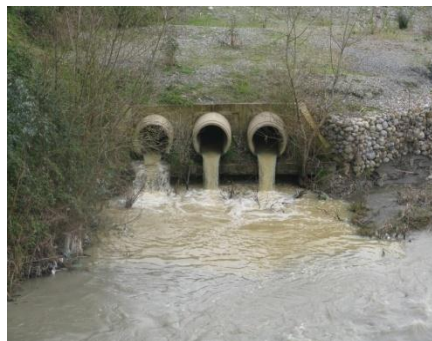
Photo 01 : Les rejets d'eaux usées urbaines
