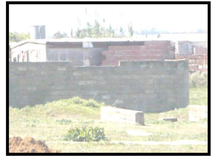
Photo n° 60: Habitat construit en métal et lorsqu'il s'est dégradé, son propriétaire a commencé de le changer par la brique.
