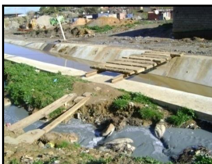
Photo n° 18 : Les eaux usées industrielles polluées versantes sans épuration dans l'Oued Moutas vers la ZET Beni Caid, malgré l'existence d'une station d'épuration propre à la tannerie.
