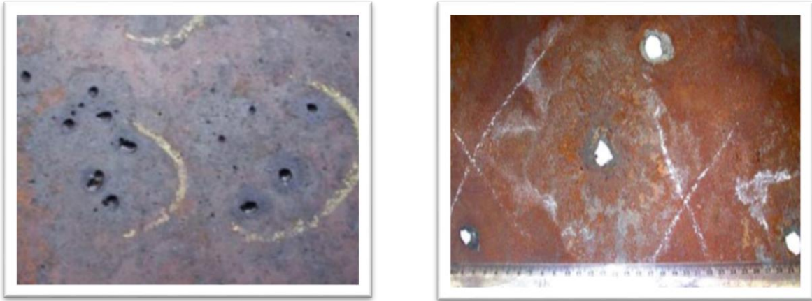
Figure II. 2. Corrosion par pique
