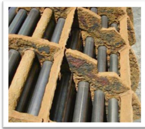
Figure II. 5. Corrosion galvanique des chicanes en acier de l'échangeur (Tubes en alliage de titanium)
