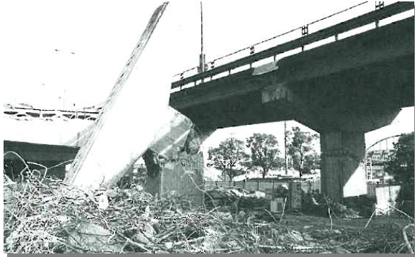
Figure 1-1 : Rupture d'une pile par flexion-cisaillement (Kobe, 1995), d'après [Priestley et al., 1996].
