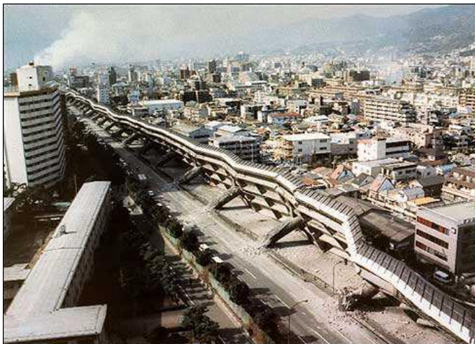
Figure 1-3 : Rupture en flexion des piles de pont de la Hanshin expressway (Kobe, 1995)
